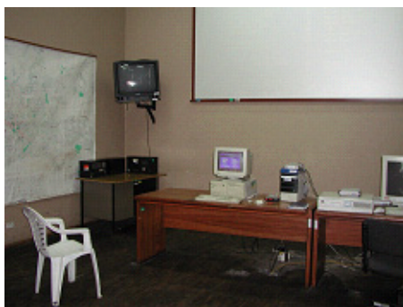
Figura 6.1-5 Centro de Control de Tránsito
